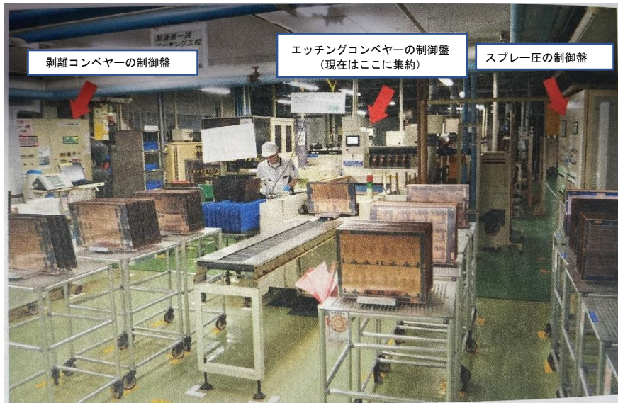
図 エッチング工程ラインの制御盤は従来 3 カ所に分かれていた (出所：日経ものづくり)
